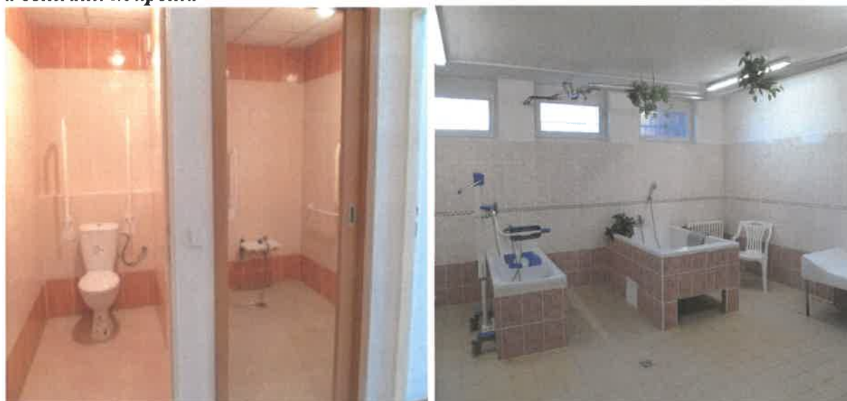
Obrázek č. 6 Objekt Jiřího Wolкера 404, Most – zrekonstruovaná sociální zařízení a centrální koupelna
